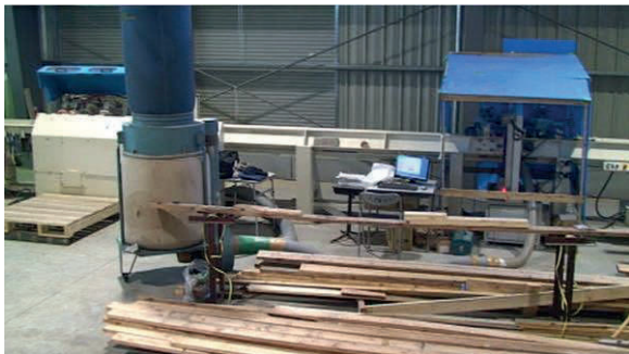
▲ 0号機の設置状況 福井県にて
